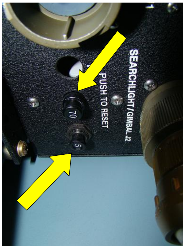
C: Disjuntores de proteção.
