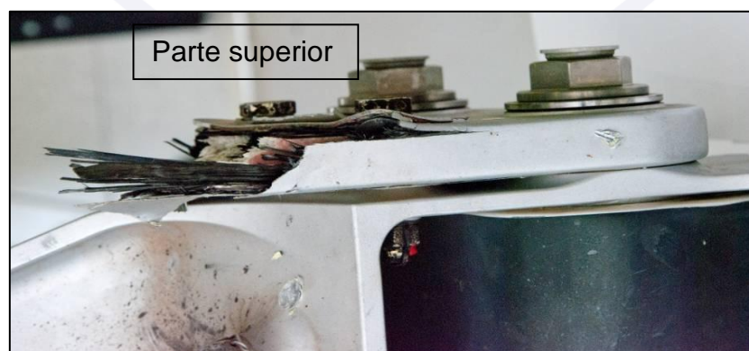
Figura 21 - Detalhe da fratura da parte superior.
