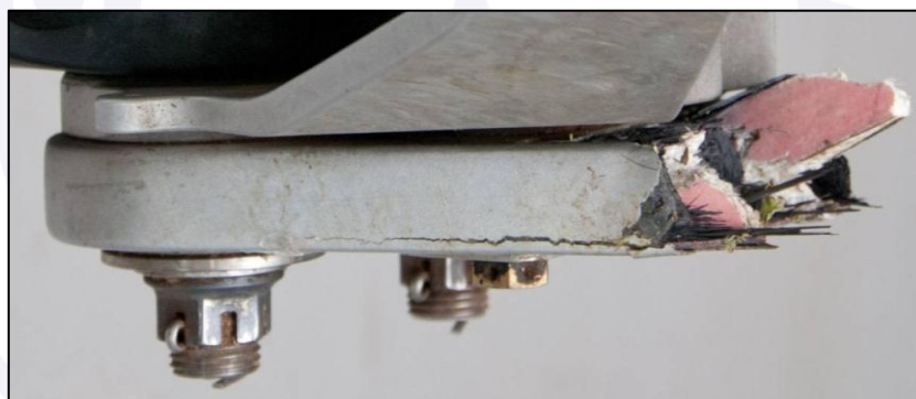
Figura 24 - Pode-se observar na superfície da fratura regiões de compressão e de tração.
