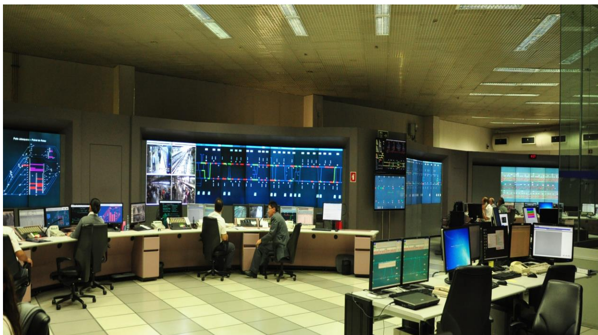
Ilustração 40 – Centro de Operações do Metrô
